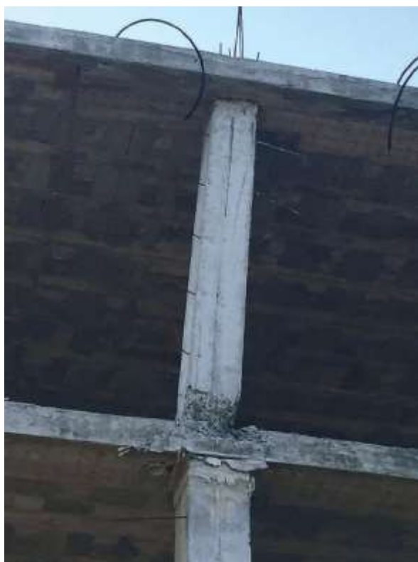
Figura 171: Edificación fuera de aplomo. Terremoto de Pedernales, Ecuador 2016.
