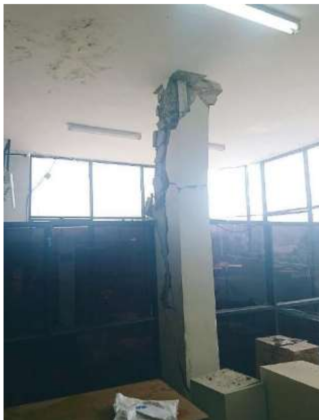
Figura 174: Daños severos en columna interna. Terremoto de Pedernales, Ecuador 2016.
