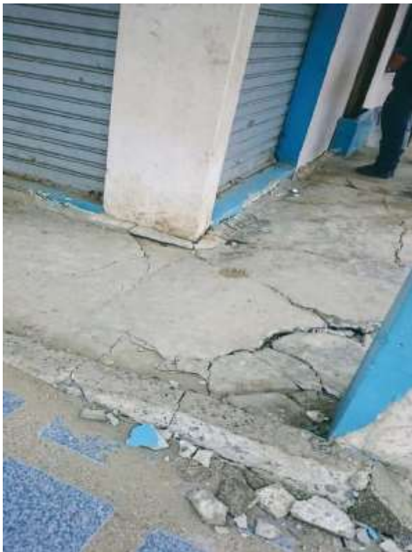
a) Hundimiento de columna
