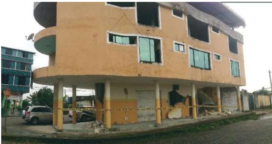
Figura 179: Revestimientos y mamposterías amenazan caer. El Carmen, Manabí, Ecuador 2016.
