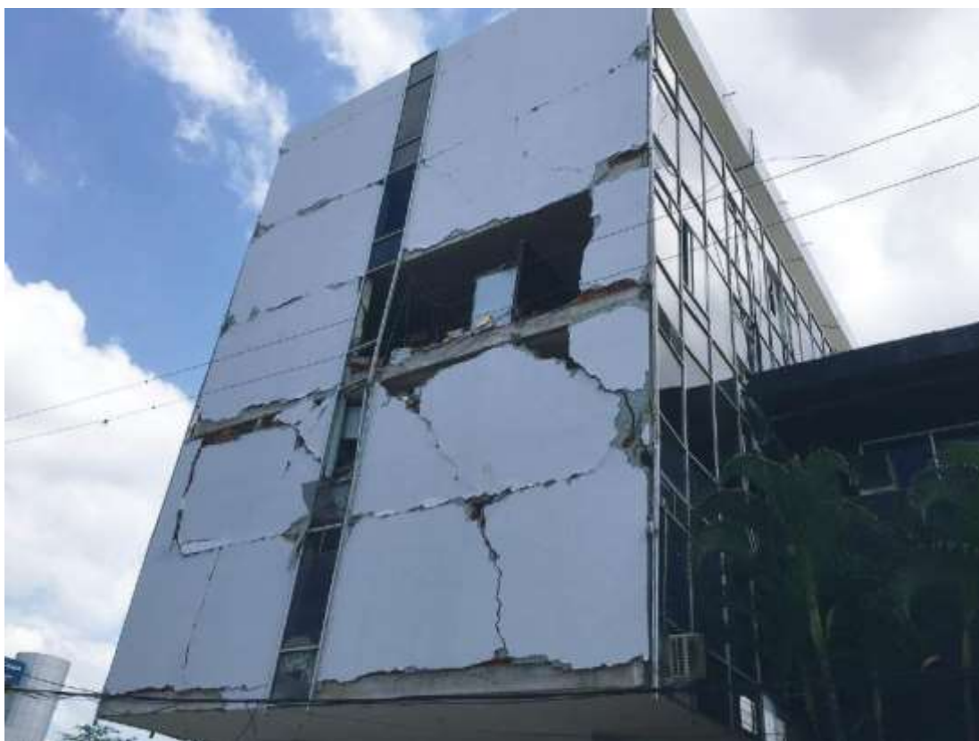
Figura 177: Grietas grandes en paredes u otros daños severos. Señalizar Inseguro. Terremoto de Pedernales, Ecuador 2016.
