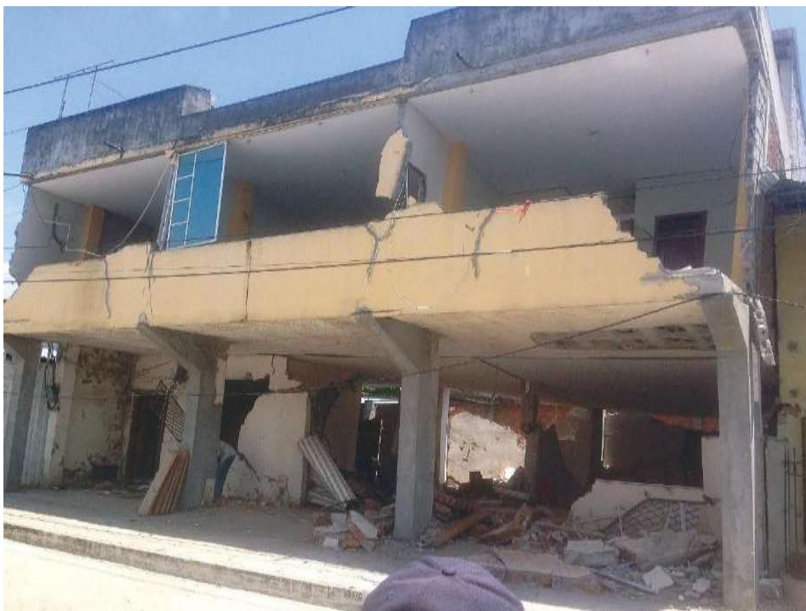
Figura 155: Vista externa de una estructura. Terremoto de Pedernales, Ecuador 2016.
