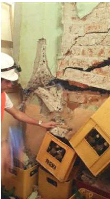
Figura 175: Daño severo en columnas, grietas grandes en pared de ladrillo. Terremoto de Pedernales, Ecuador 2016.
