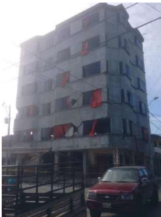
Figura 185: Revestimientos y mamposterías amenazan caer. Terremoto de Pedernales, Ecuador 2016.
