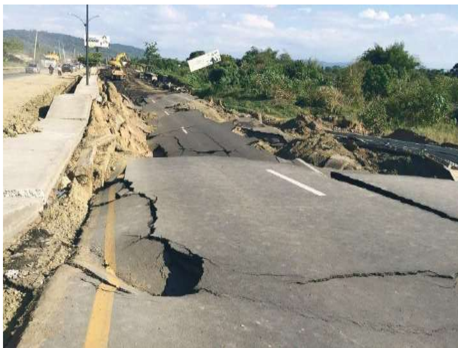
Figura 186: Hundimiento de la calzada producido por movimiento del suelo. Manabí, Ecuador, 2016
