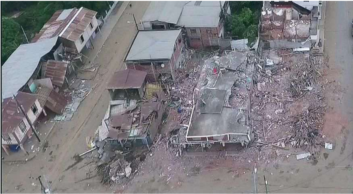
Figura 161: Colapso total de las estructuras. Jama, Ecuador 2016.
