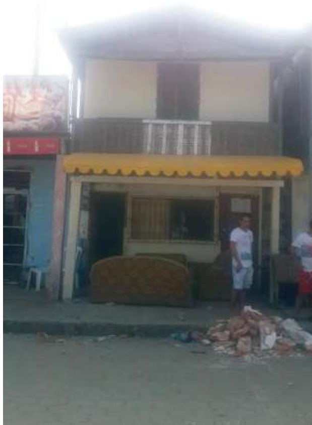
Figura 170: Edificación fuera de aplomo. Terremoto de Pedernales, Ecuador 2016.
