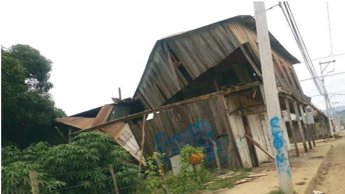
Figura 162: Colapso parcial de la estructura. Jama, Ecuador 2016.
