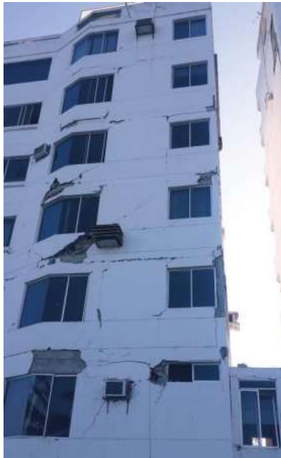
Figura 181: Fisuras severas en mampostería, amenaza caer. Bahía, Ecuador 2016.
