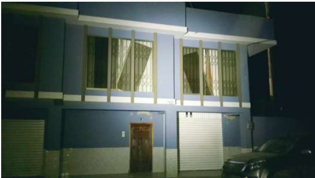
Figura 182: Ventanas corren riesgo de caer. Terremoto de Pedernales, Ecuador 2016.
