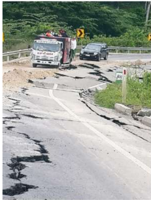
b) Grietas en el suelo
