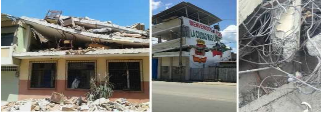
Figura 24: Losas planas con vigas banda. Fallos por punzonamiento
