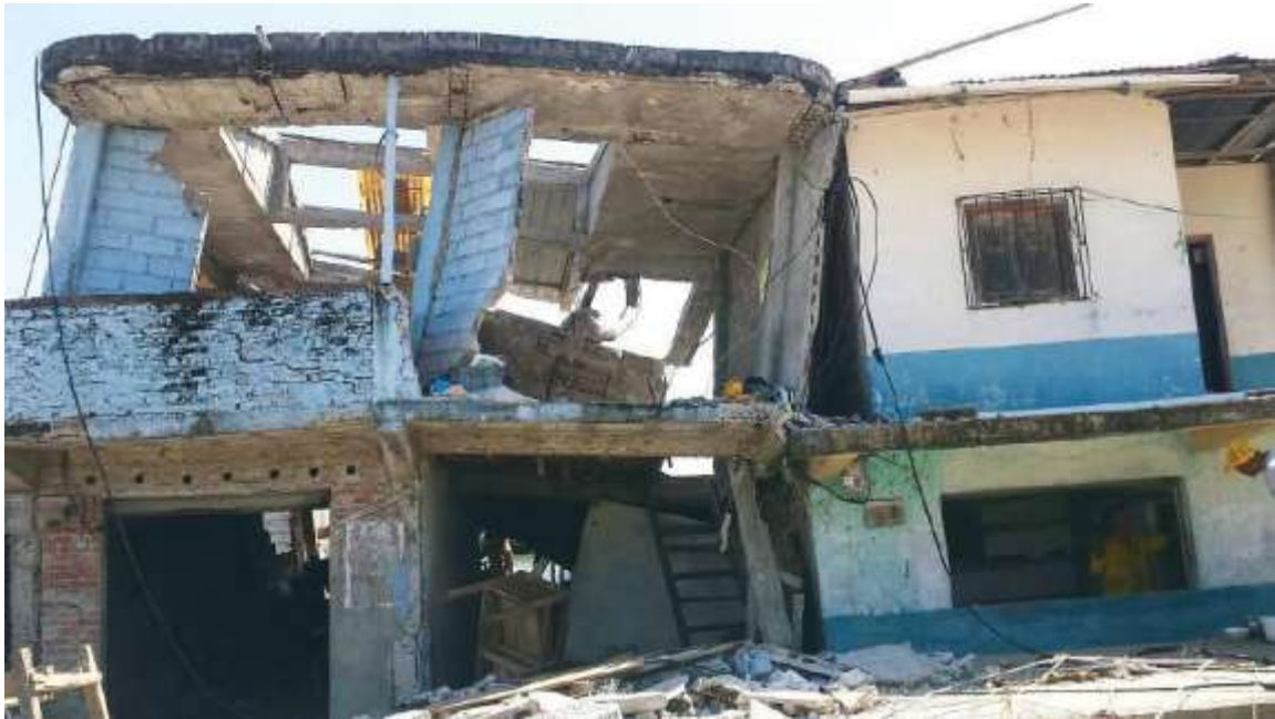
Figura 169: Edificación fuera de aplomo. Terremoto de Pedernales, Ecuador 2016.
