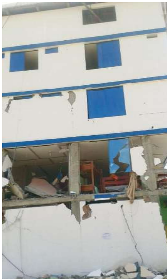
Figura 184: Revestimientos y escombros amenazan caer. Bahía, Manabí, Ecuador 2016.
