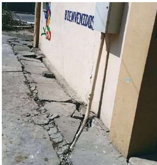
Figura 33: Vista de una escuela con un asentamiento, luego del sismo del 16 de abril de 2016 en Manta, Ecuador.
