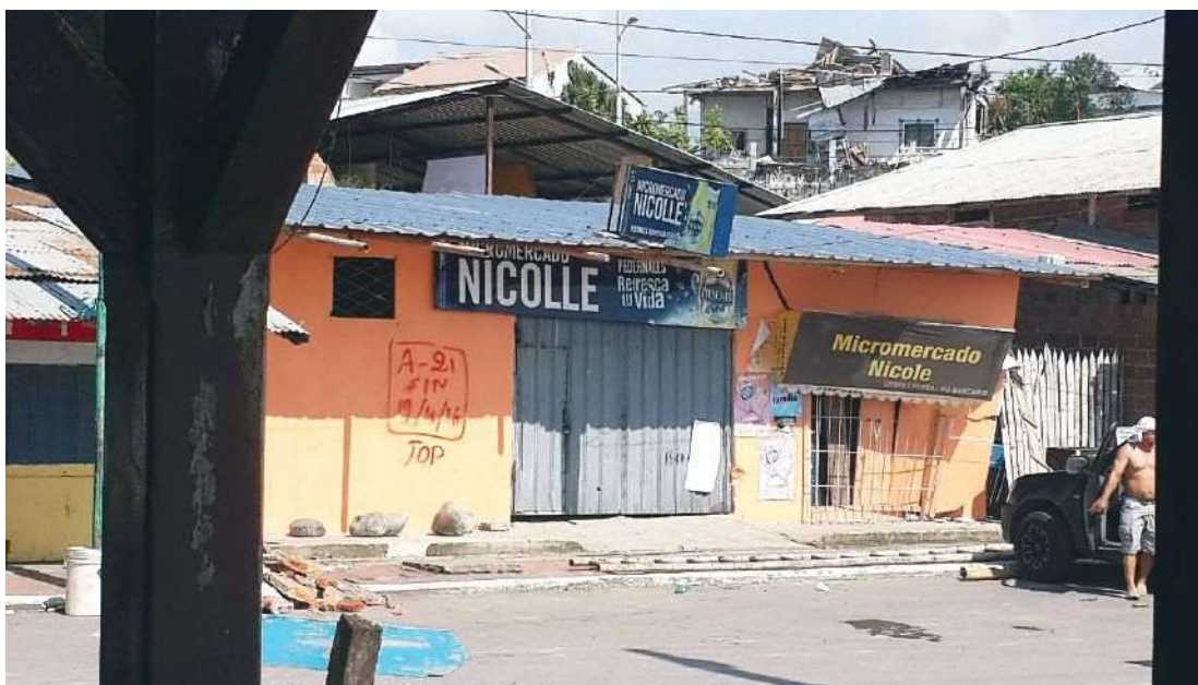
Figura 178: Grietas grandes en paredes u otros daños severos, pared a punto de caer. Señalizar Inseguro. Terremoto de Pedernales, Ecuador 2016.
