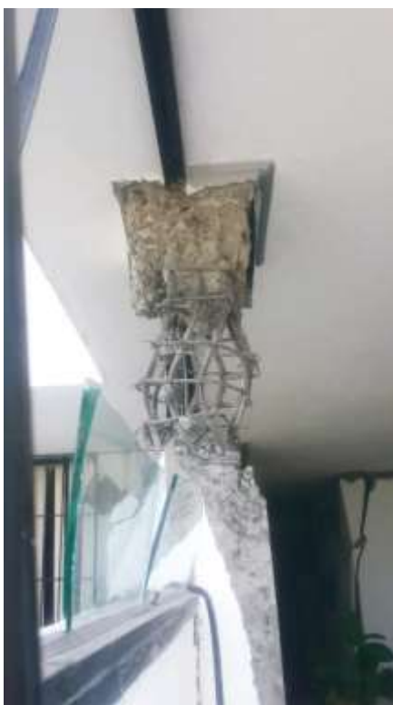
Figura 176: Daño severo en columnas, efecto de torsión. Terremoto de Pedernales, Ecuador 2016.
