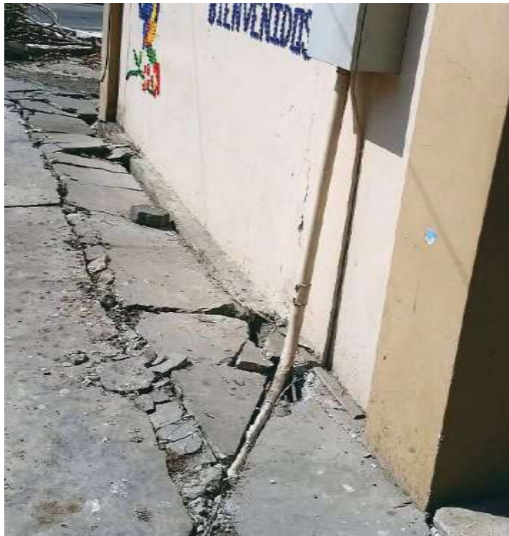
Figura 165: Cimentación afectada por problemas geotécnicos. Manta, Ecuador 2016.
