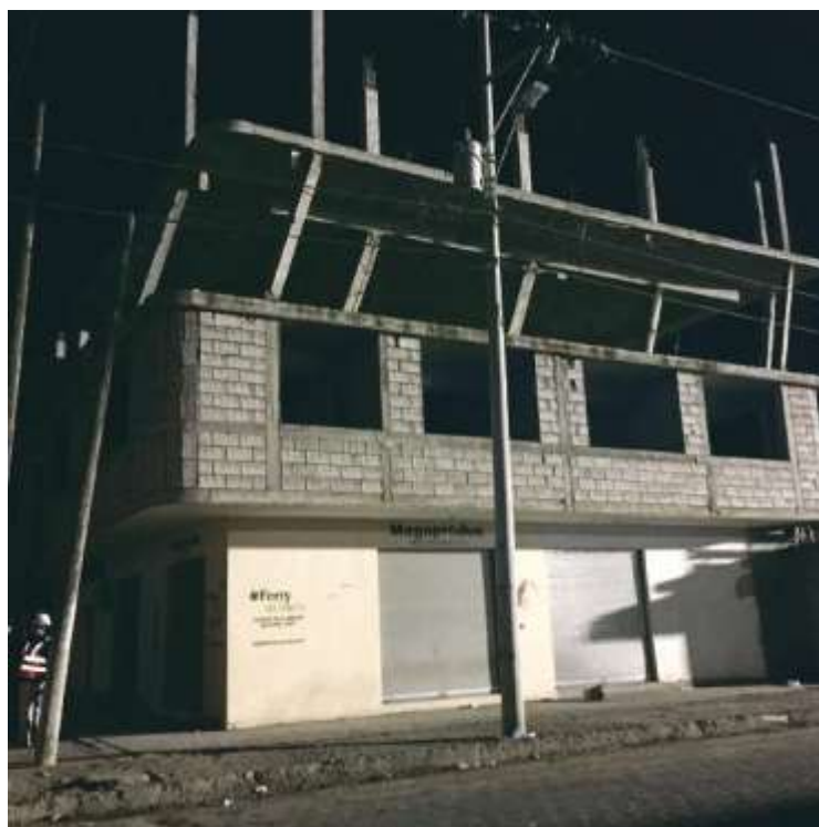
Figura 168: Edificación fuera de aplomo. Terremoto de Pedernales, Ecuador 2016.
