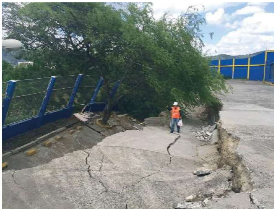
Figura 189: Colapso en veredas producto del movimiento del suelo. Manabí, Ecuador, 2016
