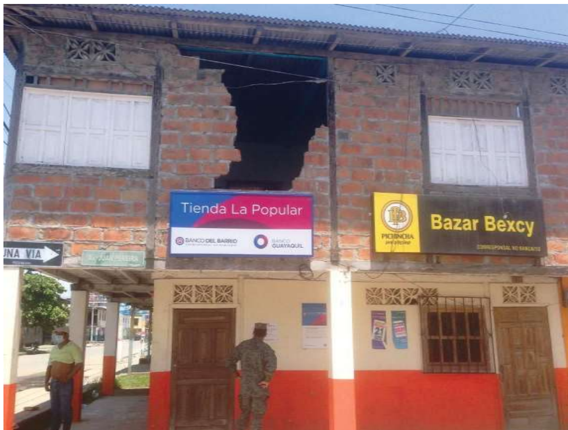
Figura 180: Revestimientos y mamposterías amenazan caer. Pedernales, Manabí, Ecuador 2016.
