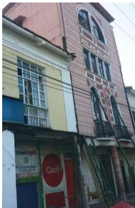
Figura 172: Edificación fuera de aplomo, se puede observar apuntalamiento por seguridad. Bahía, Ecuador 2016.
