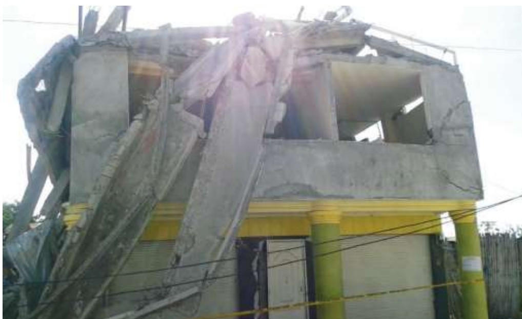
Figura 164: Colapso total de la estructura. Terremoto de Pedernales, Ecuador 2016.
