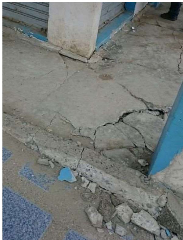
Figura 166: Hundimiento de cimentación. Muisne, Ecuador 2016.
