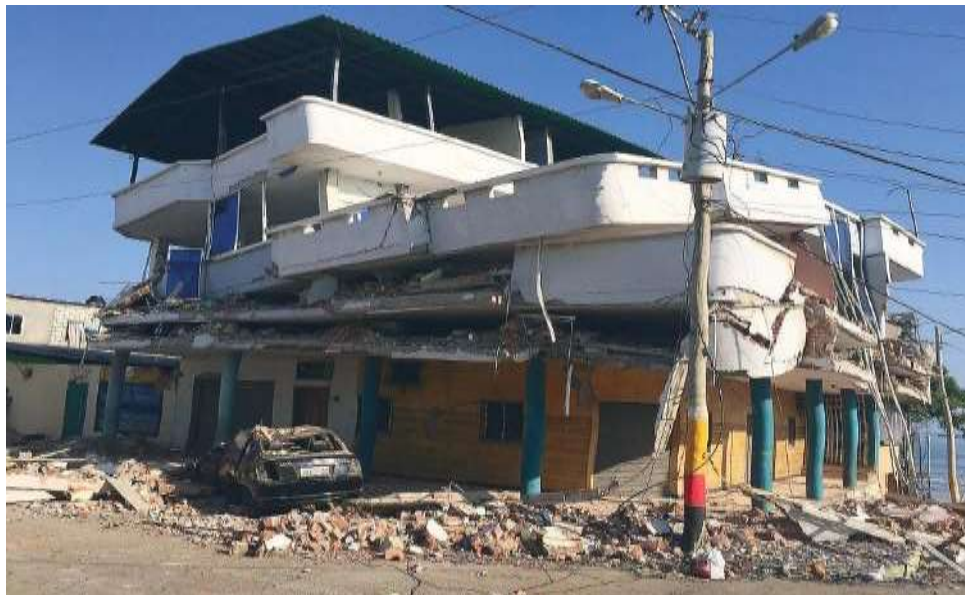
Figura 159: Colapso total de la estructura. Terremoto de Portoviejo, Ecuador 2016.
