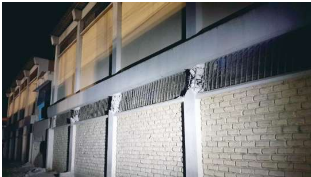
Figura 173: Daños severos en columna, explosión del hormigón. Terremoto de Pedernales, Ecuador 2016.
